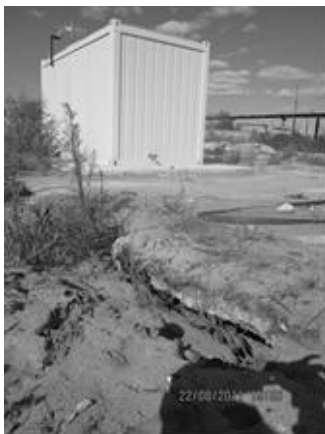
Рис. 1. Трещина отрыва и провала грунта под бетонной плитой
