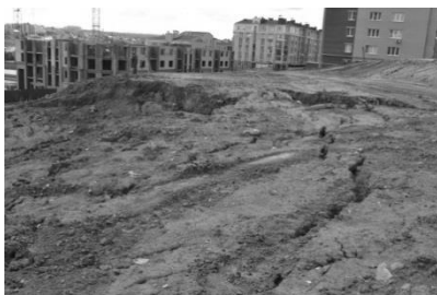
Рис.5. Оползень на площадке детского сада 5 в МКР 6 «Центр».
