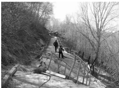
Рис.1. Овраг 5. Правый оползневый склон с деформируемой дорожкой
