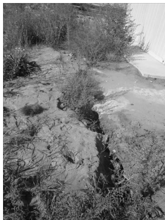
Рис. 2. Трещина размыва и отрыв грунта от бетонной плиты
